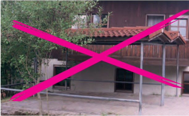
Das gut gemeinte Ziegeldach lastet hier viel zu schwer auf der filigranen Stahlkonstruktion auf.
