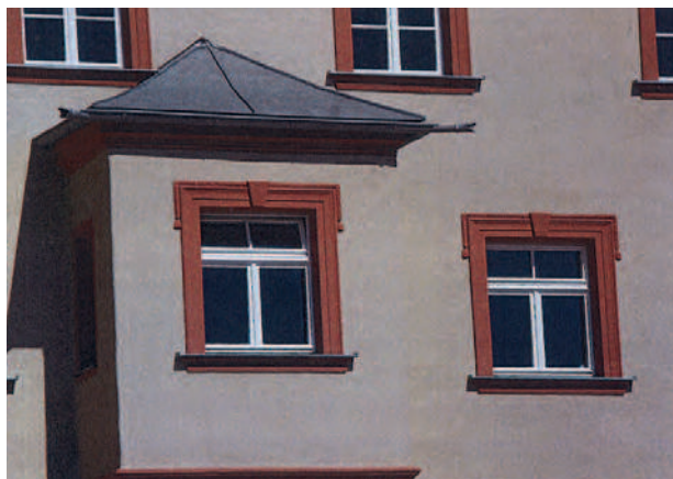
Blech als Material für Hauptdächer in der Hemauer Altstadt zeigt sich nicht vertretbar. Die Satzung beschränkt deshalb die Verwendung auf besondere Bauteile, wie z. B. Erker.
